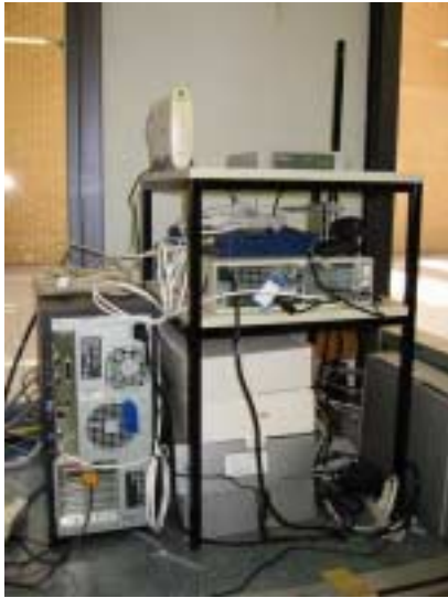
図 13 ルータ設置場所&無線基地局（プレスルーム内）
