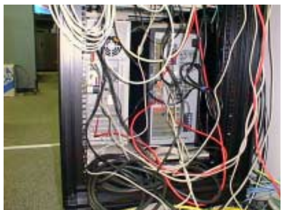
図 2 ラック内機材 (ルータ他)
